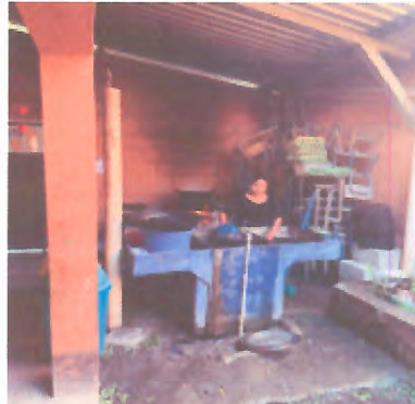
Foto 2: Vista de la cocina, la cual carece de cerramiento propio y provoca que tanto las paredes de esa area y aulas se ahumen.
