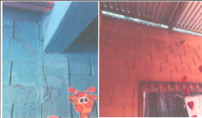
Foto 4: Necesidad de pintura general y mejoramiento de paredes, las cuales se han ahumado en general.
